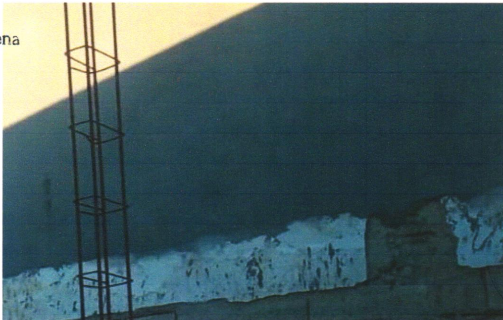
FOTO 12 – MASSA ÚNICA, PARA RECEBIMENTO DE PINTURA OU CERÂMICA, ARGAMASSA INDUSTRIALIZADA, PREPARO MECÂNICO, APLICADO COM EQUIPAMENTO DE MISTURA E PROJEÇÃO DE 1,5 M 3 /H EM FACES INTERNAS DE PAREDES, ESPESSURA DE 5MM, SEM EXECUÇÃO DE TALISCAS. AF_06/2014
